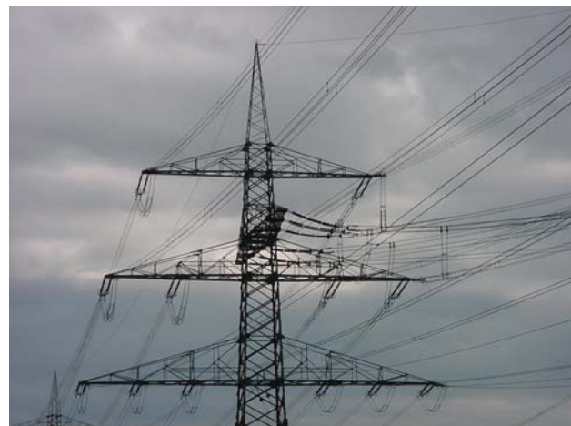
Abb. 5: „Abzweigmast“ für die 380kV-Leitungen St. Peter Nord und Frimmersdorf 6f
